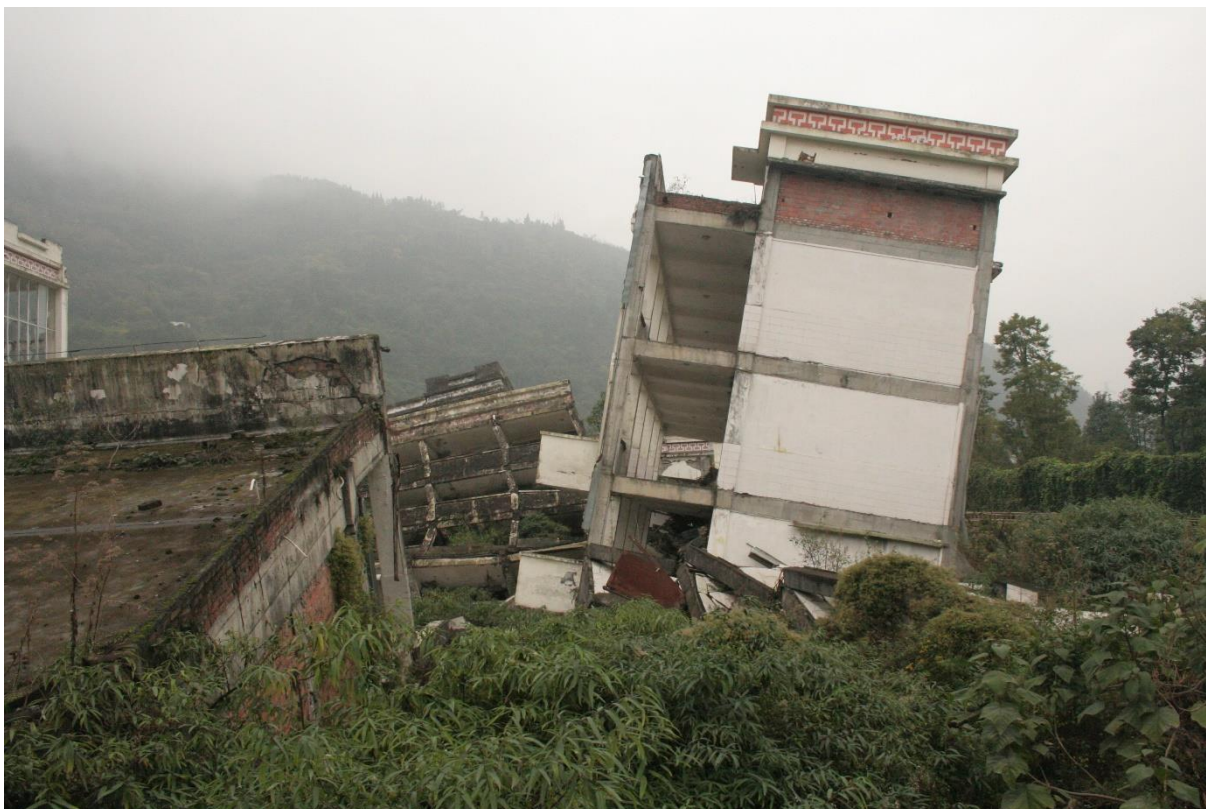
Zniszczona zabudowa z płyt betonowych w epicentrum trzęsienia ziemi Wenchuan z 12 maja 2008 roku.
